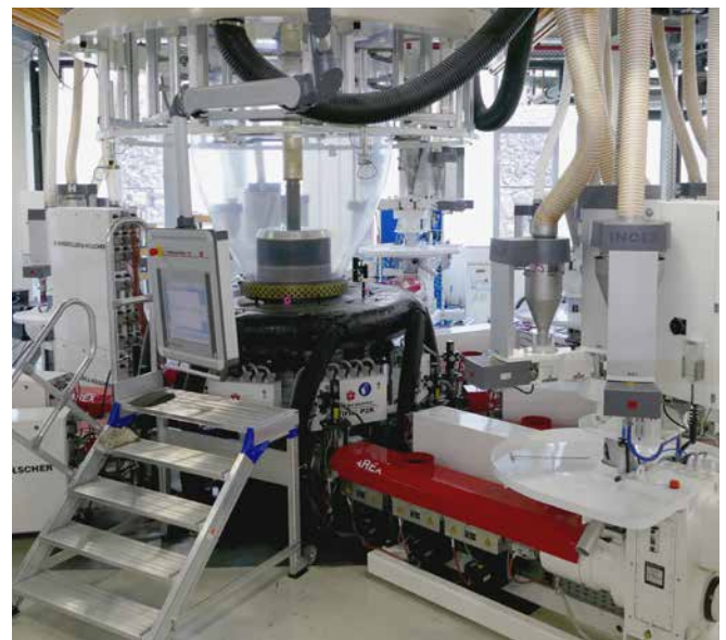
rechts: ... die aus den jeweiligen Quellen zur Coextrusionsanlage transportiert werden müssen.
