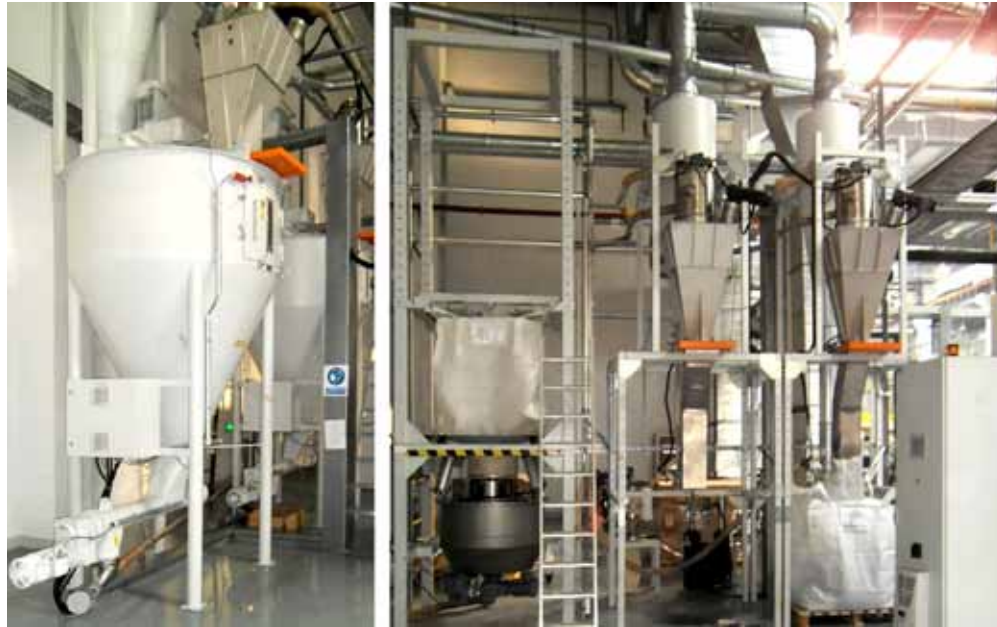
TPO-Mahlguthandling in doppelter Ausführung, getrennt für helle und dunkle Folientypen: Mischtrichter, um unterschiedliche Mahlgutchargen vor dem Zudosieren am Extrudereinzug homogen zu mischen (Bild links) – Entleer- und Befüllstationen für die Big-Bags (rechts).
